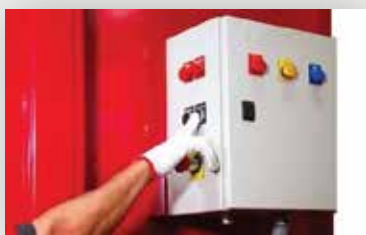
لوحة التحكم Control panel
