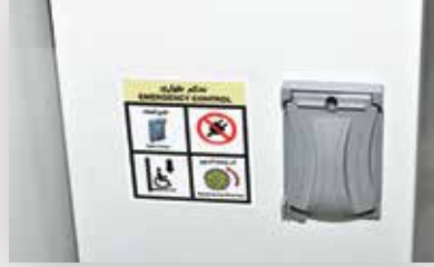
تحكم طوارئ Emergency control
