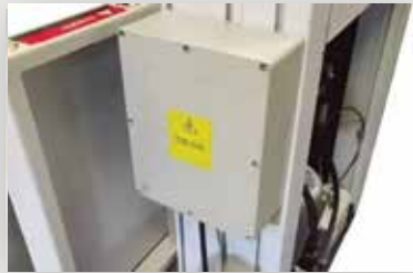
صندوق تحكم كهربائي
