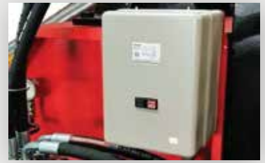
لوحة كهرباء Electrical panel
